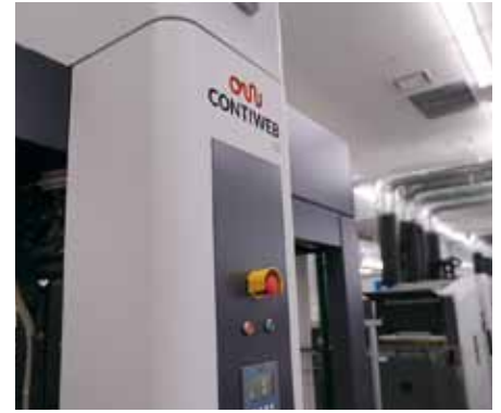
2号機にはオートスライサーをインラインで接続
